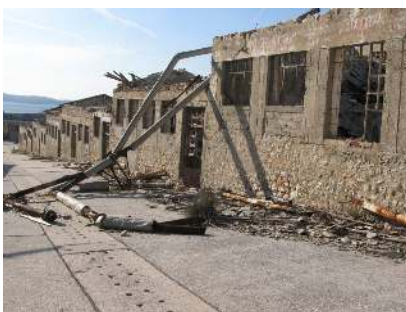
Verlassenes Gebäude und verbogenes Gelände.
