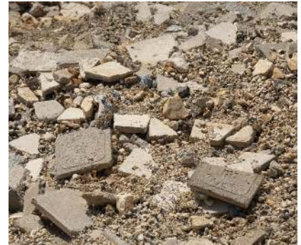
Fliesenreste am Boden.
