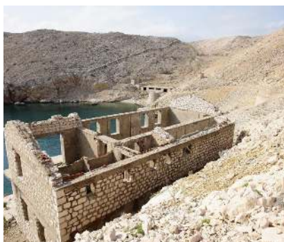
Bâtiment sans toit au-dessus d'une crique.
