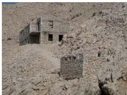
Ruine d'un bâtiment à deux niveaux.
