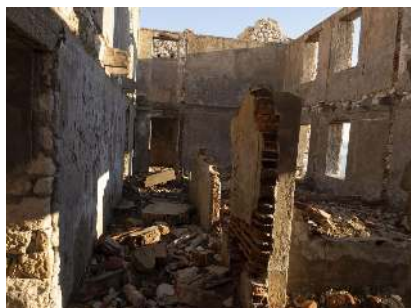
Intérieur d'un bâtiment effondré.
