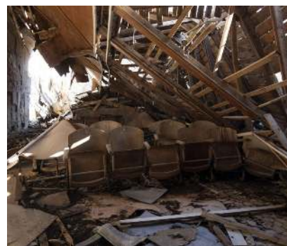
Urušena unutrašnjost zgrade.
