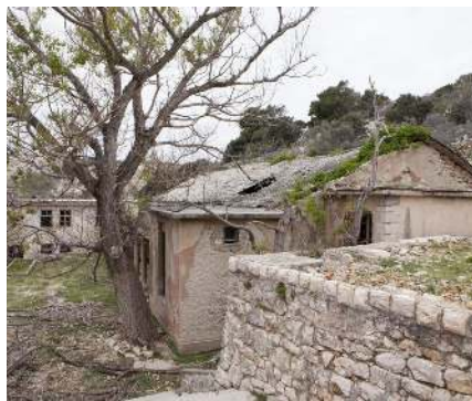
Urušena kamena zgrada.
