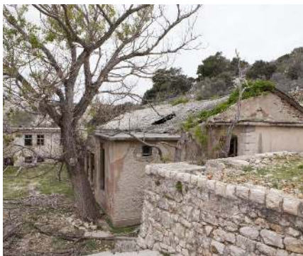
Edificio di pietra crollato.
