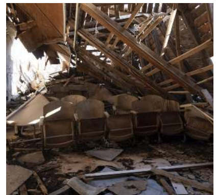
Interno crollato di un edificio.
