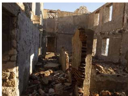
Interno di un edificio crollato.
