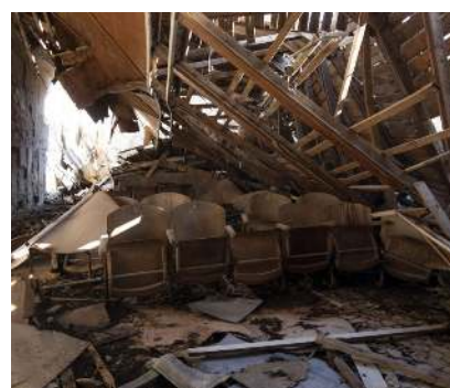
Porušena notranjost stavbe.
